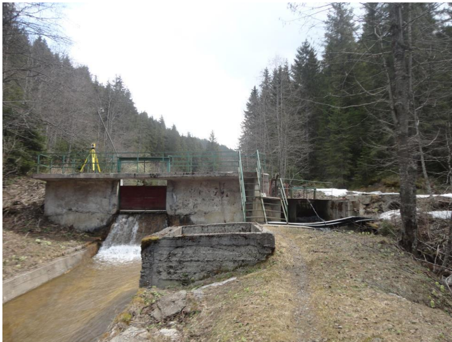
Figura 10.4-5: Captare existentă Valea Azugii
